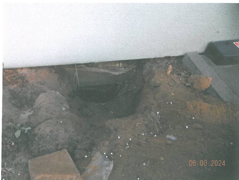
Fot. 2 – gruz w wykopie przy fundamencie
