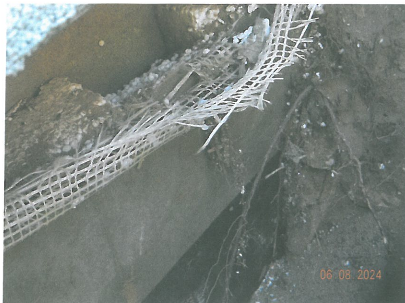
Fot. 1 – izolacja bitumiczna wykonana do połowy tylko na izolacji termicznej, brak izolacji bitumicznej wykonanej bezpośrednio na ścianie fundamentowej
