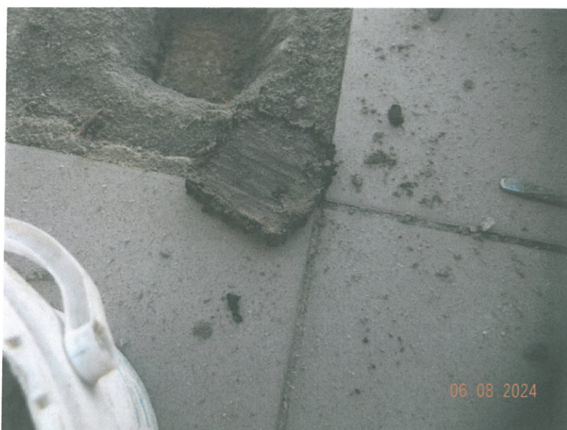
Fot. 4 – izolacja bitumiczna zamiast folii
